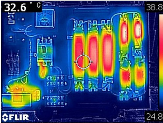
配電盤内の発熱監視 (MSX画像)
